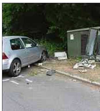
Der Stromverteiler wurde beim Unfall beschädigt. (Foto: Polizei)
